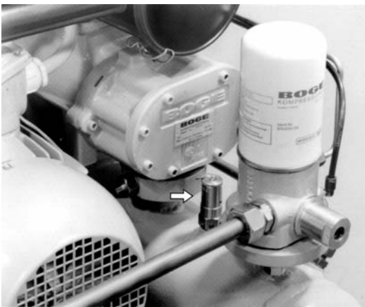
Bild 3.42: Sicherheitsventil am Schraubenkompressor
